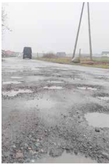
Dla mieszkańców Nowych Kulic widoczne na zdjęciu dziury to dopiero początek drogi przez mękę
