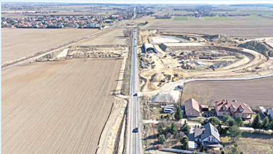
Budowa 12-kilometrowego odcinka S17 między Zamościem a Łabuniami ma zakończyć się w tym roku
