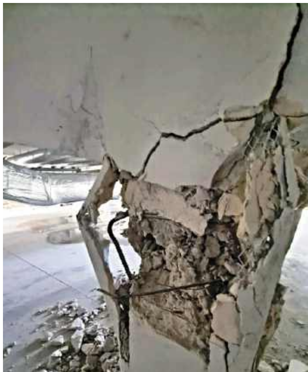
Pęknięcie słupa - specjaliści nie stwierdzili katastrofy budowlanej
