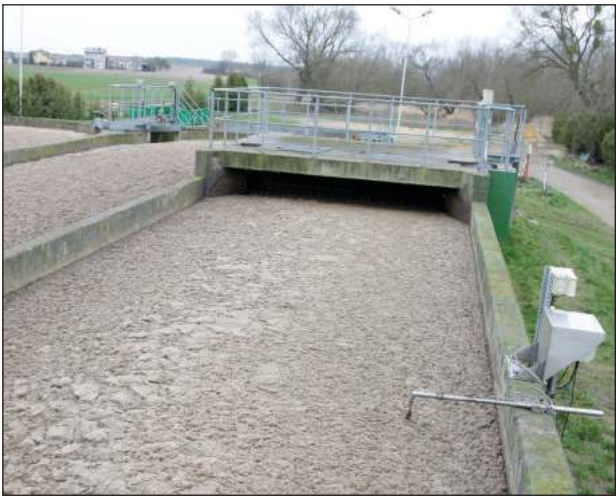
Widoczny na zdjęciu kożuch - jak mówi wójt - dokładnie obrazuje problem i konieczność modernizacji
