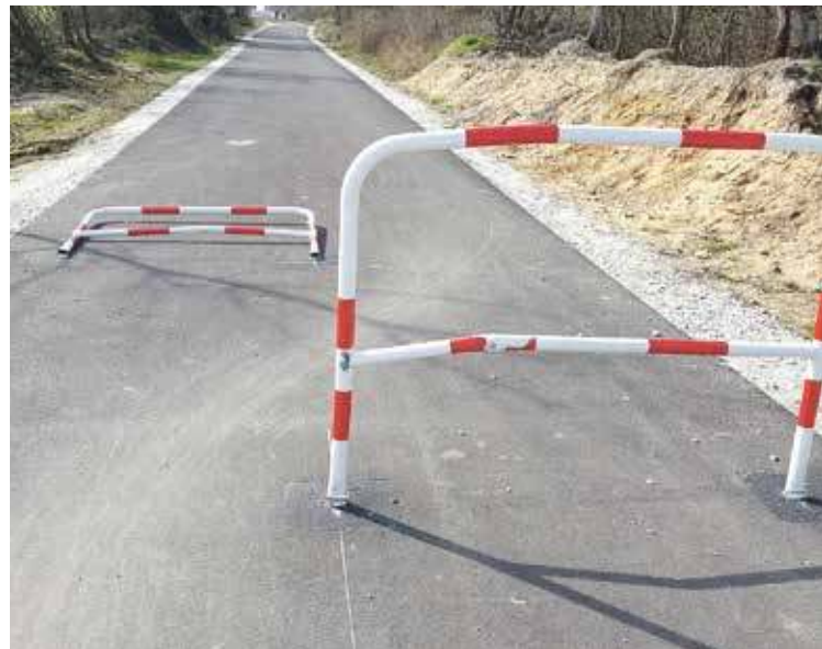
Jedna leży, druga jest wygięta. Żeby zrobić takie uszkodzenia potrzeba sporo siły.
