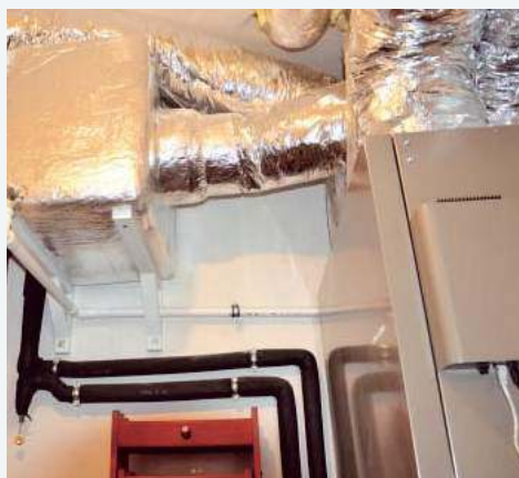
➤ Przewód z czerpnią, na niej wymiennik glikol–powietrze z doprowadzeniem rur z glikolem z pionowego GWC (w czarnej izolacji).
