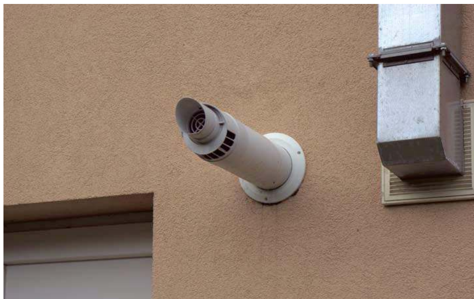
📍 Zamknięta komora spalania i koncentryczny przewód powietrzno-spalinowy – tylko pod tymi warunkami wentylacja kotłowni może być inna niż grawitacyjna. J. ANKIEWICZ
