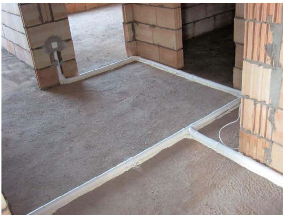
🔧 Rurociąg powinien być jak najkrótszy i mieć jak najmniej załamań. TOPVAC
