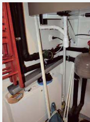
Na rurze z glikolem (z GWC) jest pompa obiegowa. Rurki białe odprowadzają skropliny do szamba.
