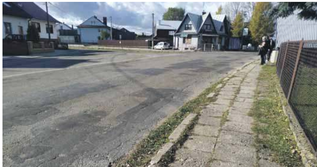
Chodnik przy głównej drodze w Krempachach jest w bardzo złym stanie.
