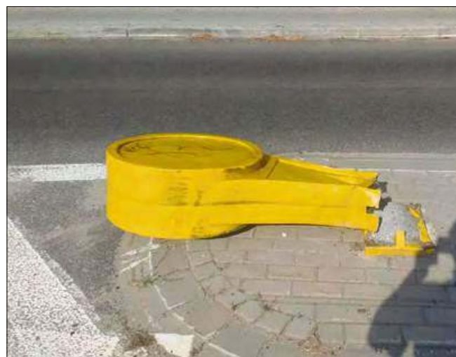
Wandale nie oszczędzili nawet znaków drogowych.
