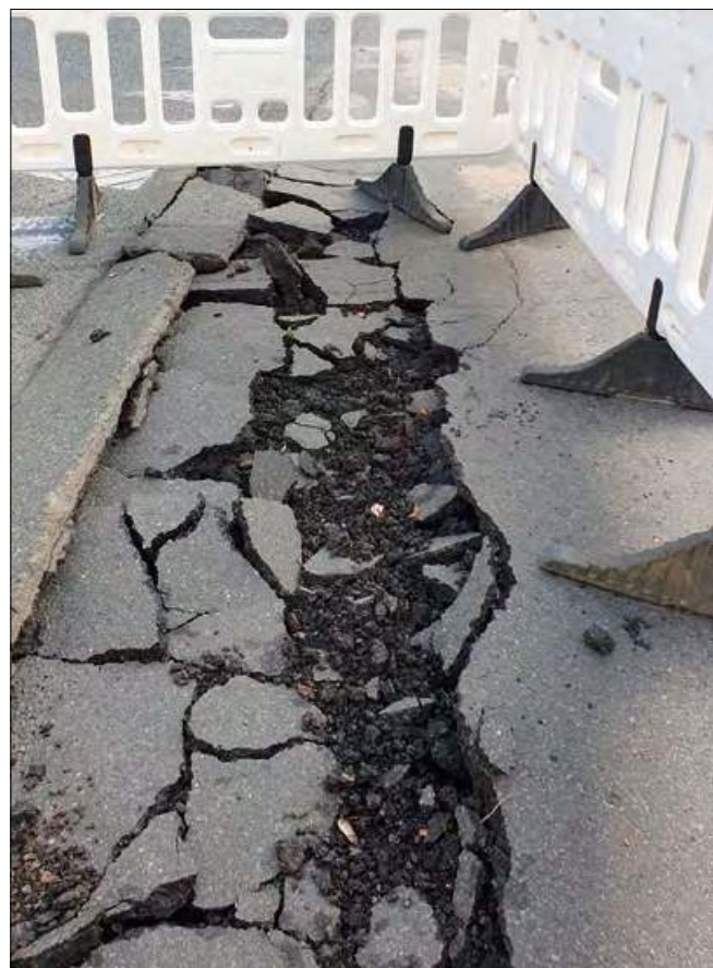
Ulewa przeszła, szkody zostały.
