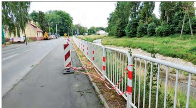
W ramach zadania zaplanowano: rozbiórkę zniszczonej nawierzchni i podbudowy; remont nasypu ścieżki; wykonanie nowej podbudowy i nawierzchni; montaż elementów betonowych; ustawienie barier zabezpieczających; wykonanie oznakowania poziomego.
