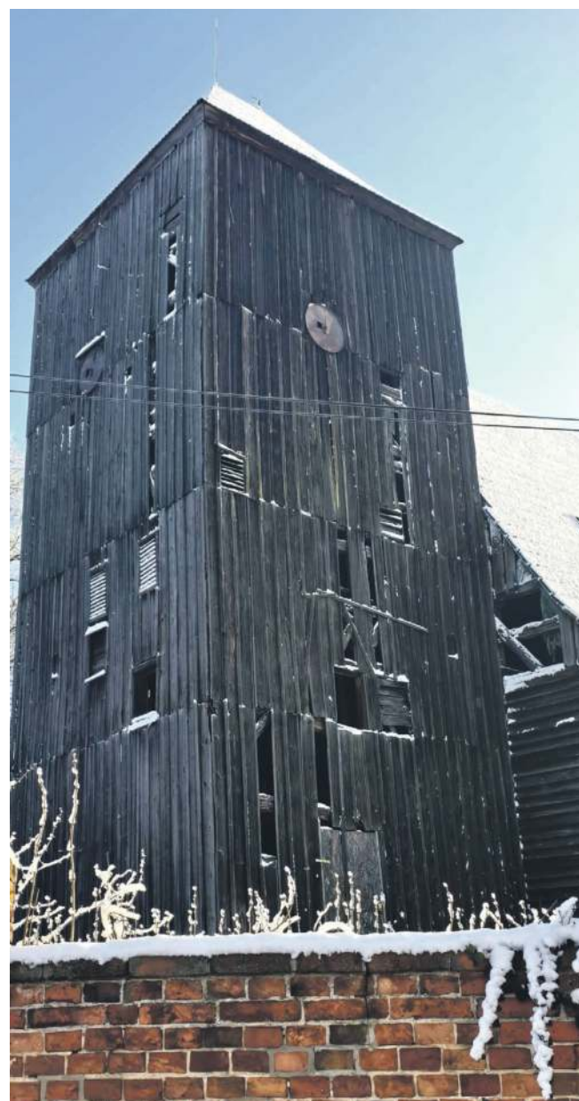
Dziury w wieży
