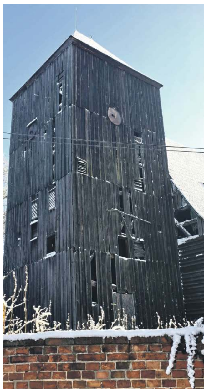
Dziury w wieży
