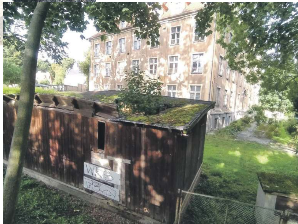
Przez dach widać wyrastające drzewa
