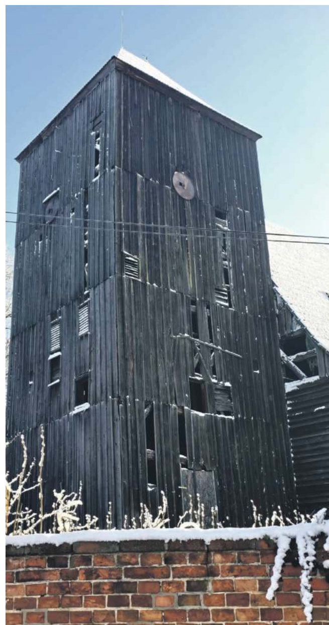
Dziury w wieży
