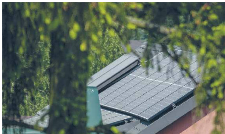
„Odnawialne źródła energii” – instalacja fotowoltaiczna
