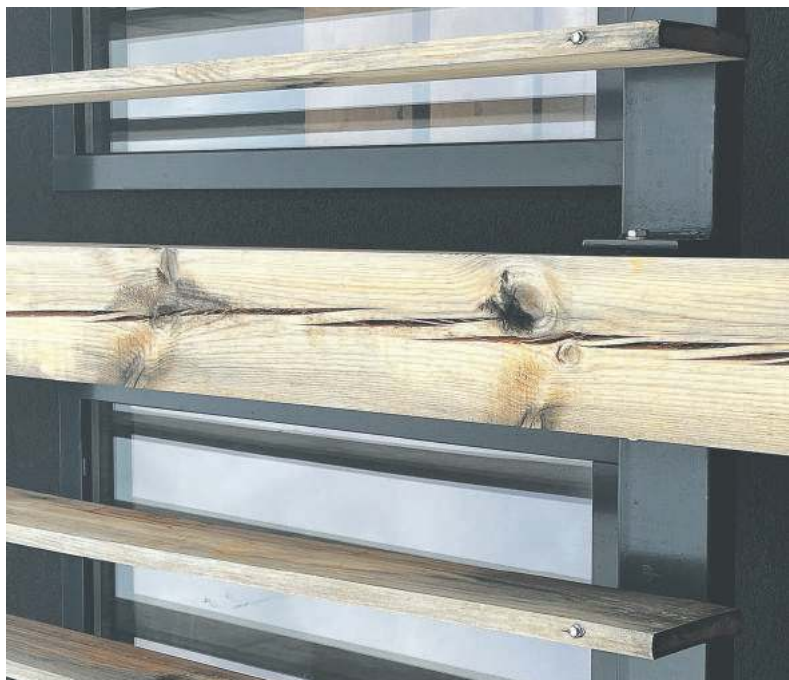
Jedno z pęknięć, o których wspominał radny Dariusz Przytuła
