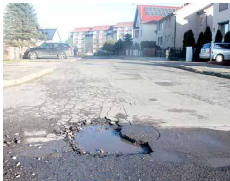
Jeszcze kilka dni temu ta spora dziura "witała" kierowców już przy wjeździe na drogę na Kasprowicza
