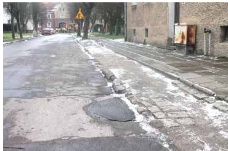
Urząd zapowiada, że gdy tylko pogoda pozwoli, to usterki na drodze zostaną naprawione
