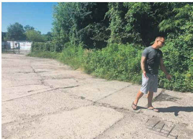
Z betonowych płyt na dawnej fablokowskiej drodze wystają metalowe pręty. Jazda tą trasą to wyzwanie dla zawieszenia samochodu
