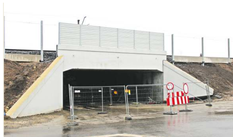
Kiedy zakończą się prace przy wiadukcie nad ul. Zejera, robotnicy zainstalują za wiadukt przy Kużaju
