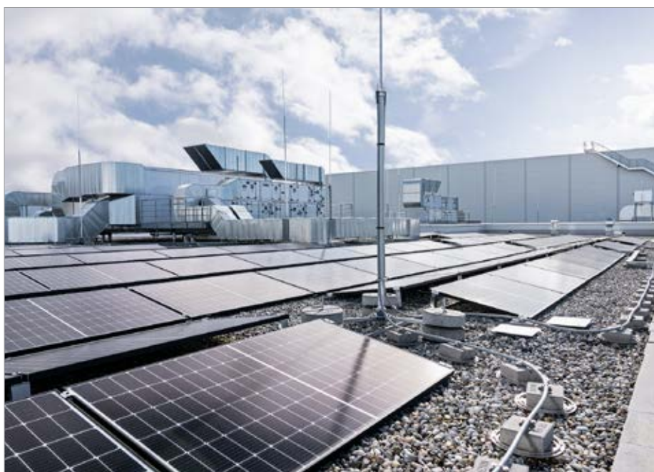
Rys. 5. Zastosowanie przewodu HVI light plus po modyfikacji systemu LPS na dachu (dodanie instalacji fotowoltaicznej)
