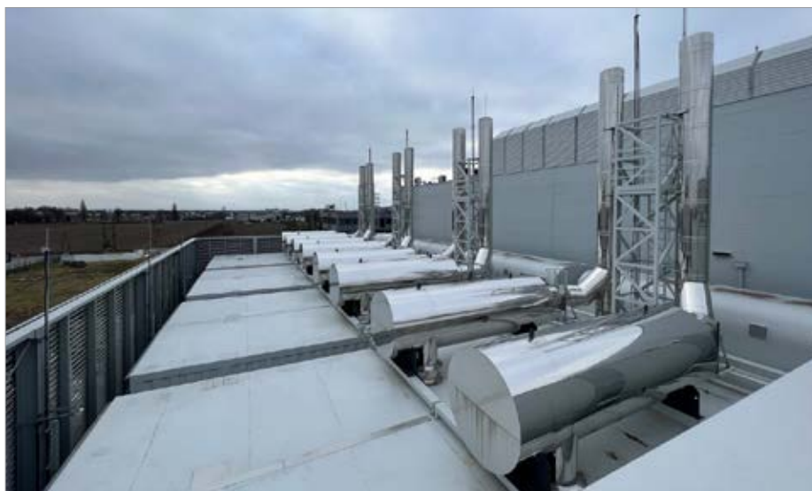
Fot. 2. Obiekt Data Center w technologii prefabrykowanej, z modułową częścią energetyczną obejmującą kontenerowe stacje SN i nn oraz kontenerowe agregaty prądowórcze fot. Mariusz Kordeczka
