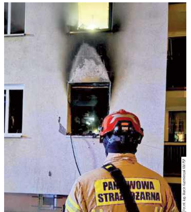
Wypalone okno w kuchni mieszkania, które spłonęło doszczętnie. Na pierwszym piętrze widać pękniętą szybę pod wpływem gorąca
