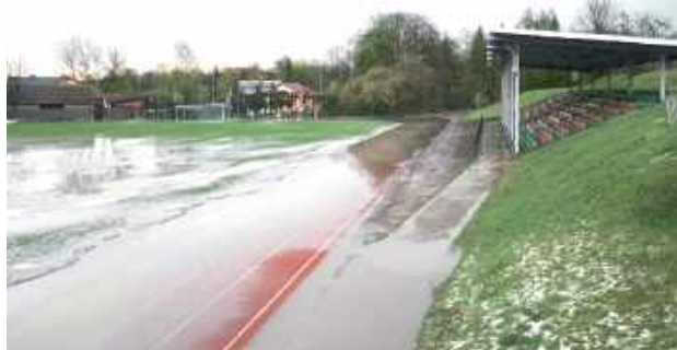
Stadion w Tarnogrodzie kompletnie zniszczony przez wodę
