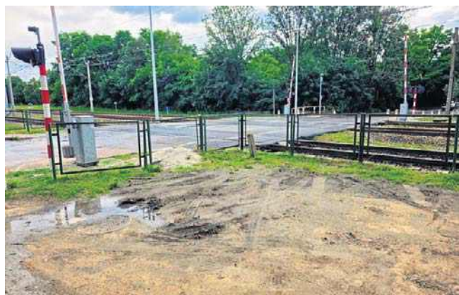
Miejsce, w którym zapadła się ziemia to centrum miasta. Zaledwie 300 metrów od niego znajduje się rynek
