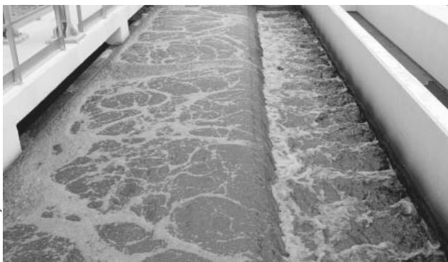
Oczyszczalnia ścieków w Mławie
