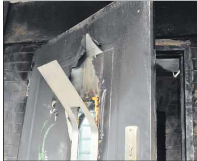
■ Uszkodzone od ognia drzwi wejściowe
