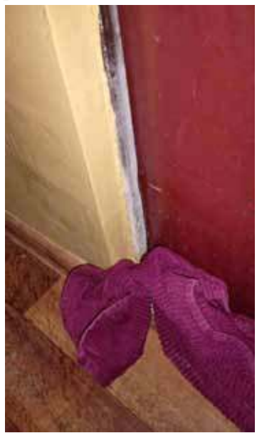
Przy nieszczelnych drzwiach pojawiła się gruba warstwa szronu. Woda następnie się tam skraplała, stąd była konieczność położenia ręcznika
