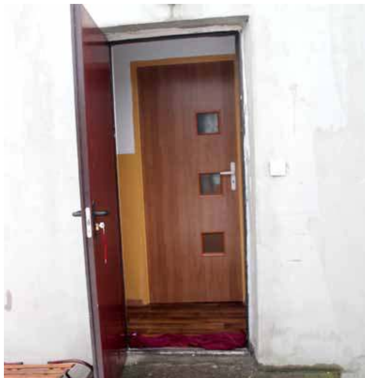
Nieszczelne drzwi prowadzą do sieni, w której znajduje się toaleta. Kobieta musiała okładać je ręcznikami
