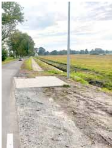
Tak wygląda powiatowy chodnik prowadzący ze wsi do Centrum Przesiadkowego
