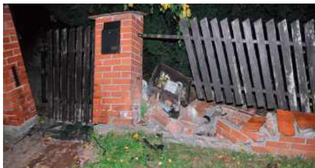
Samochód uderzył w ogrodzenie posesji i uszkodził skrzynkę gazową, z której wydobywa się gaz
