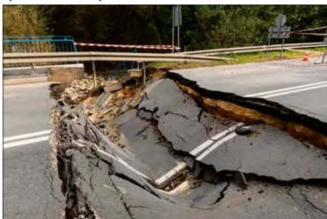
Zniszczona przeprawa przez Osobłogę jest sporym utrudnieniem dla mieszkańców.
