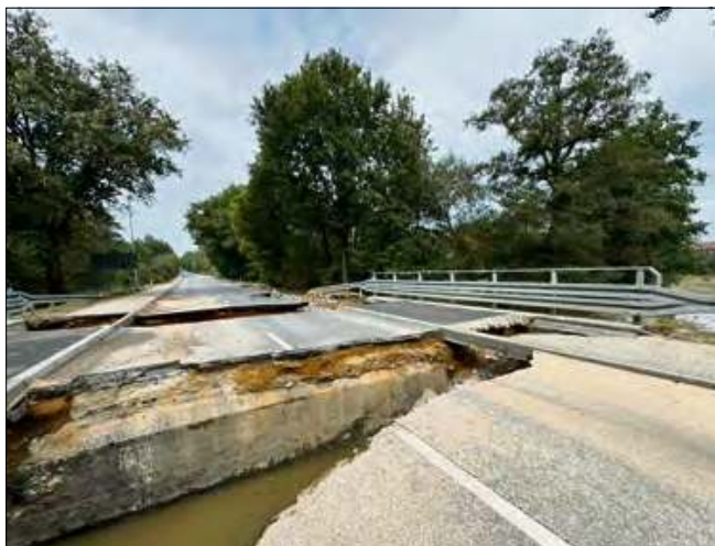
DK 45 wymaga gruntownej przebudowy.
