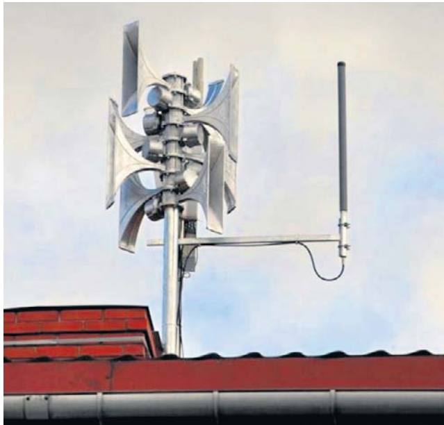
W lipcu przeprowadzono testy systemu alarmowego. Słyszalność komunikatów głosowych trzeba poprawić
