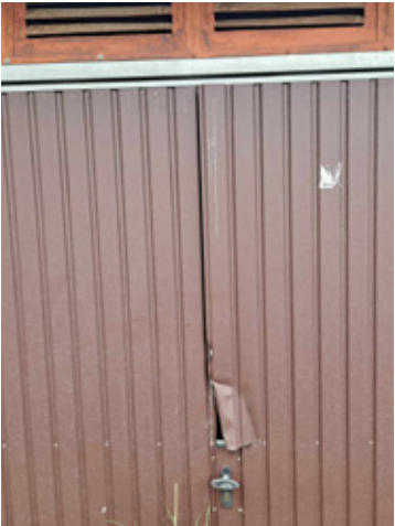
Widoczna próba włamania
