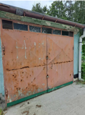
Zdewastowane drzwi garażowe
