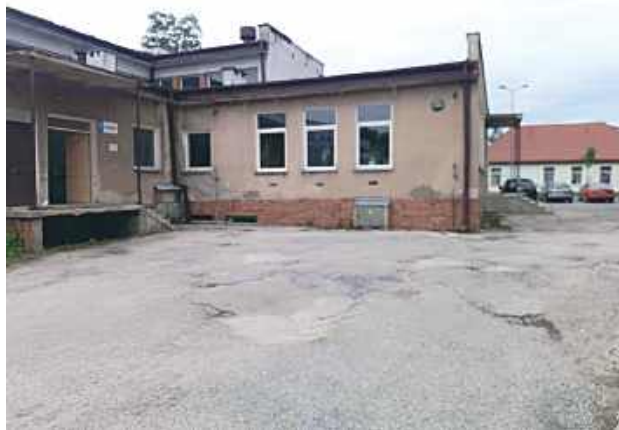
Nawierzchnia na placu szpitalnym wymaga remontu
