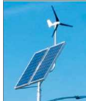
Lampy hybrydowe mogą wykorzystywać panele słoneczne do zasilania oświetlenia w ciągu dnia, a w nocy przełączać się na zasilanie sieciowe lub akumulatory
