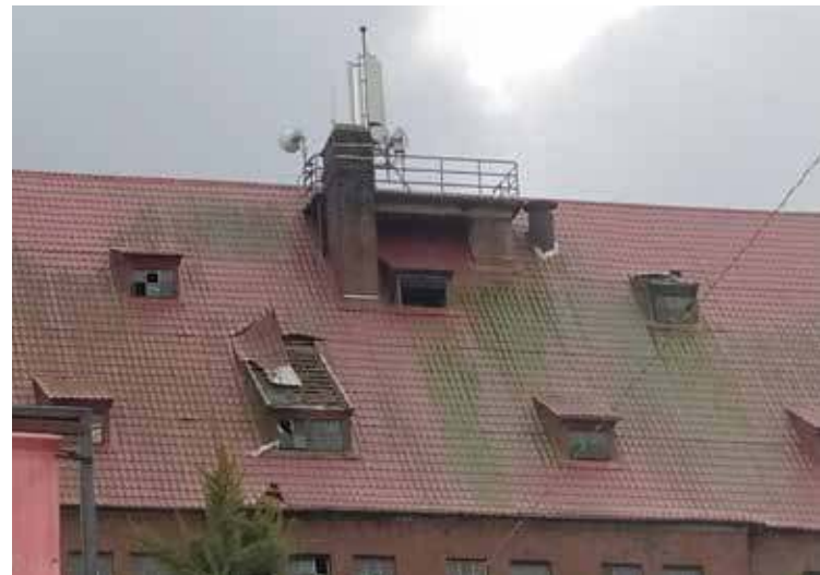
Niebezpiecznie zwisający kawałek blachy na elewatorze
