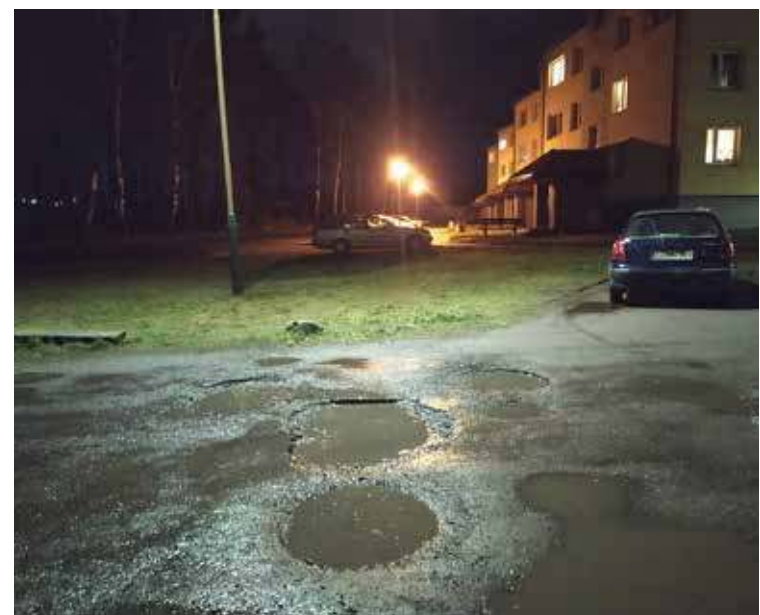
Jak wskazują mieszkańcy bloków przy ul. Leśnej, tu jest tylko dziura na dziurze. Nie sposób przejechać tak, aby tego nie odczuło auto
