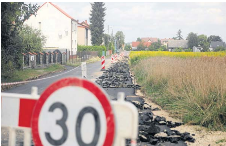
Droga przeorana przez ciągnik ma zostać naprawiona
