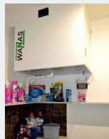
Centralę zawieszono pod płaskim stropodachem i podwieszanym sufitem w kotłowni.
