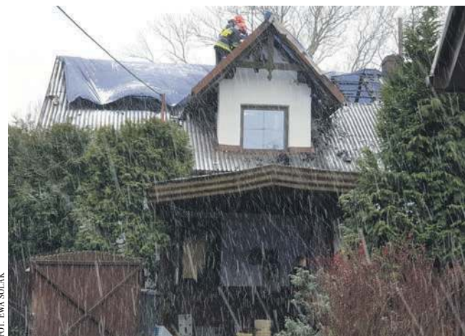
Po pożarze strażacy pomogli zabezpieczyć spalony dach
