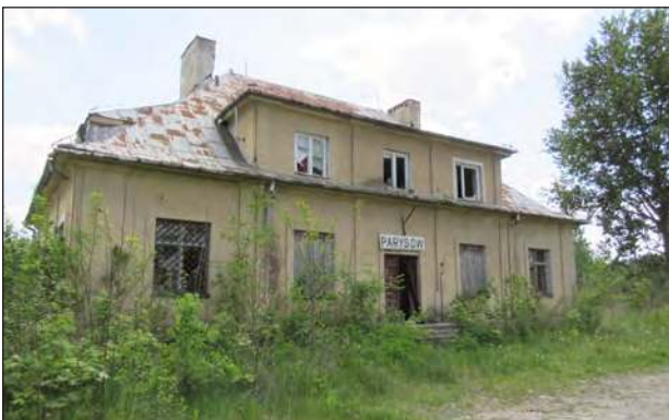
➤ Biorąc pod uwagę brak zainteresowania wynajmem dawnego dworca w Parysowie oraz zły stan techniczny budynku, PKP S.A. analizuje możliwość jego rozbioru (fot. Grzegorz W. Tężycki - Fotografia własna, CC BY-SA 4.0, https://commons.wikimedia.org/w/index.php?curid=166046935 )
