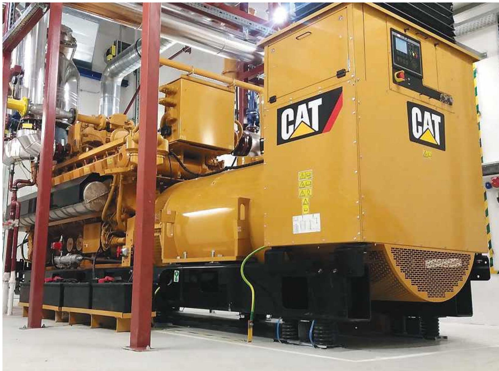
Silnik kogeneracyjny - do 2029 uruchomione zostaną jeszcze cztery silniki kogeneracyjne o łącznej mocy około 8 MW energii elektrycznej pozwolą nie tylko zwiększyć bezpieczeństwo pracy systemu, lecz również zapewnią możliwość korzystania z systemu wsparcia dla wysokosprawnej kogeneracji przez kolejne 15 lat
