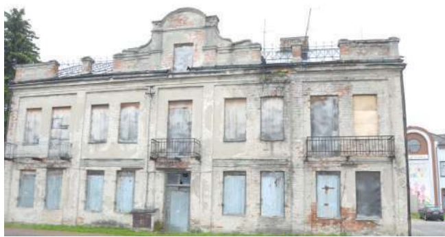
Budynek przy Urzędzie Miasta w Radzynie po ostatnim pożarze został zabezpieczony, nie można do niego wchodzić. Wybudowany w 1936 roku, jako jeden z nielicznych w mieście (może jedyny), nosi na elewacji ślady kul z czasów II wojny światowej
