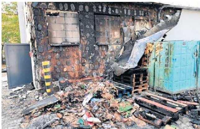
Z powodu wysokiej temperatury zniszczeniu uległy m.in. elementy instalacji
