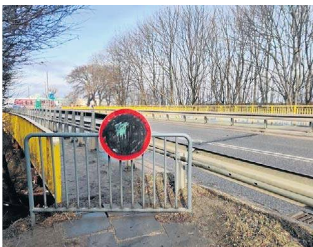
Od kilku lat piesi mają problem z wiaduktem, ponieważ jedna strona obiektu jest całkowicie niedostępna
