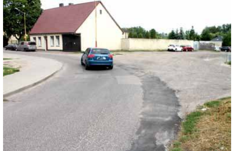
Spory ubytek masy bitumicznej na łuku drogi na ul. Łabędziej
