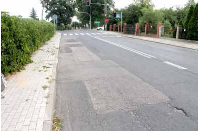
Mieszkańcy zgłaszają brak obrzeży betonowych i niestabilne kostki brukowe na ul. Lelewela
