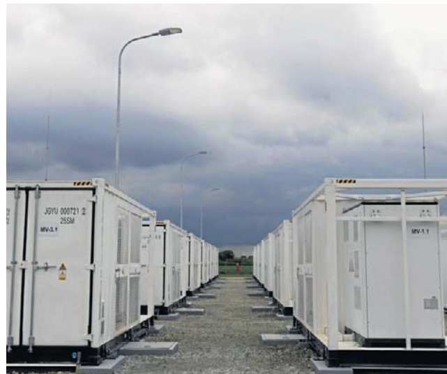
Potężny magazyn zielonej mocy pod Grodkowem, czyli 24 kontenery pełne baterii.
