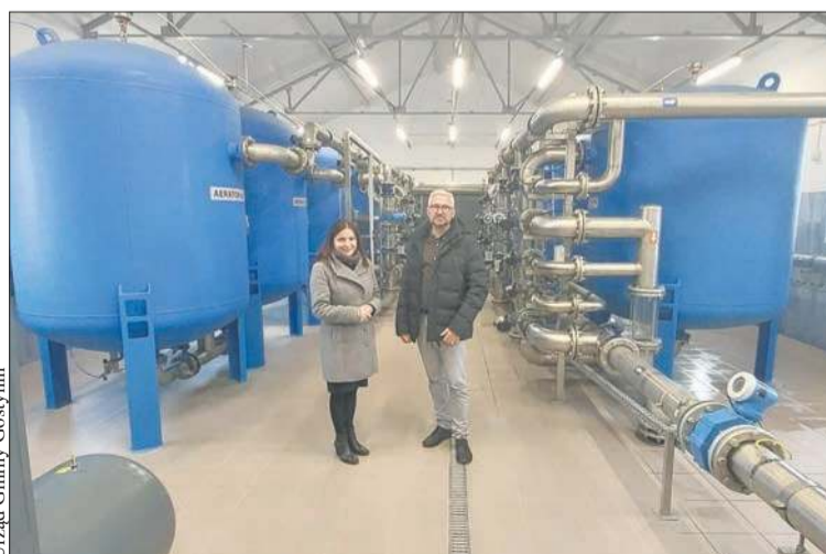
Wójt Renata Kędzińska podczas wizyty w jednej z przebudowanych stacji uzdatniania wody
