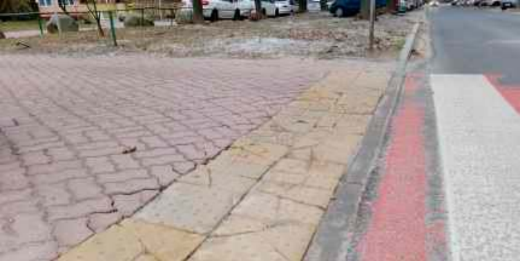
Słupki mają powstrzymać kierowców i dalsze łamanie płytek ostrzegających osoby niewidome o zbliżaniu się do przejścia
