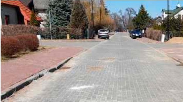
Na ulicy Leśnej i Przy Lesie krawężniki rozsypały się jak babki z piasku
