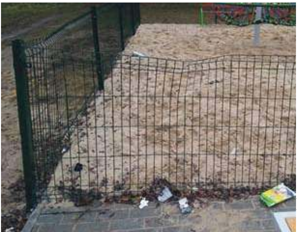
Zniszczone ogrodzenie i śmieci na nowym placu zabaw
