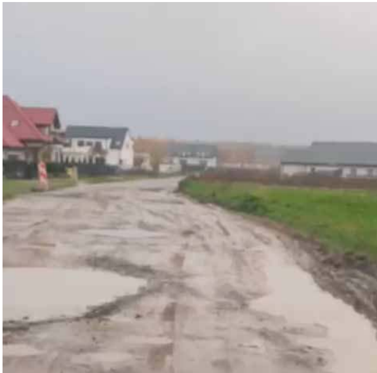
Fatalnej jakości droga gruntowa jest nieprzejezdna dla samochodów. Dzieje się to prawie po każdych opadach deszczu
