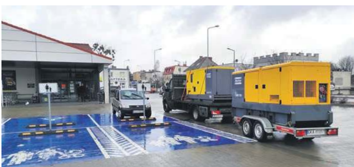
Brak energii elektrycznej spowodował znaczne problemy w funkcjonowaniu między innymi sklepów. Market przy Bytowskiej uruchomiono dzięki ściągnięciu agregatów.
