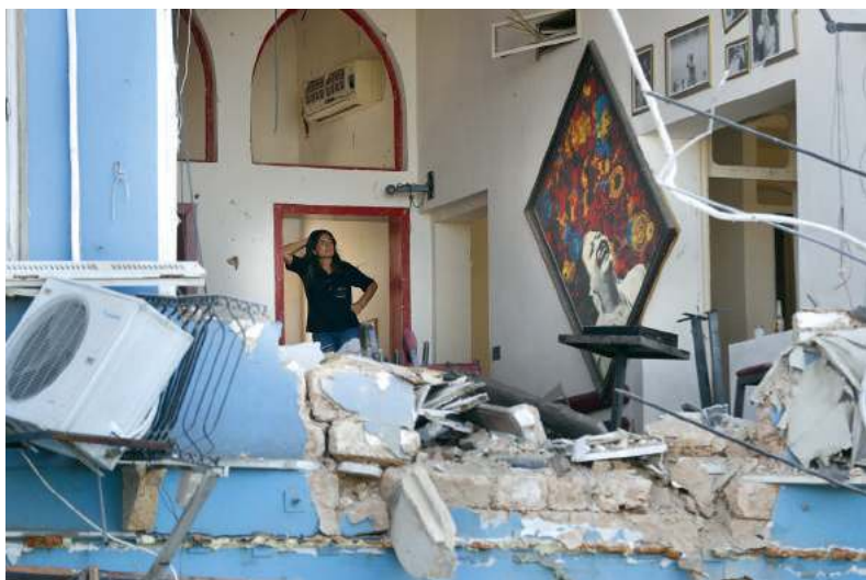
Budynki, które ocalały, muszą być sprawdzone pod kątem bezpieczeństwa.
