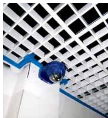
Zamontowano również kamery monitoringu
