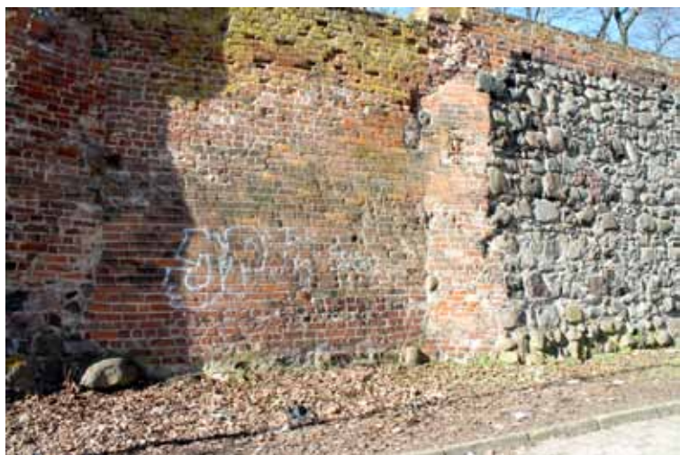
Mury obronne na wysokości ul. Warownej z takim "współczesnym napisem". Mieszkańcy żądają oczyszczenia tego historycznego elementu miejskiej przestrzeni
