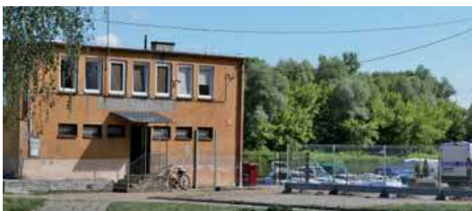
Budynek na przystani wymaga remontu
