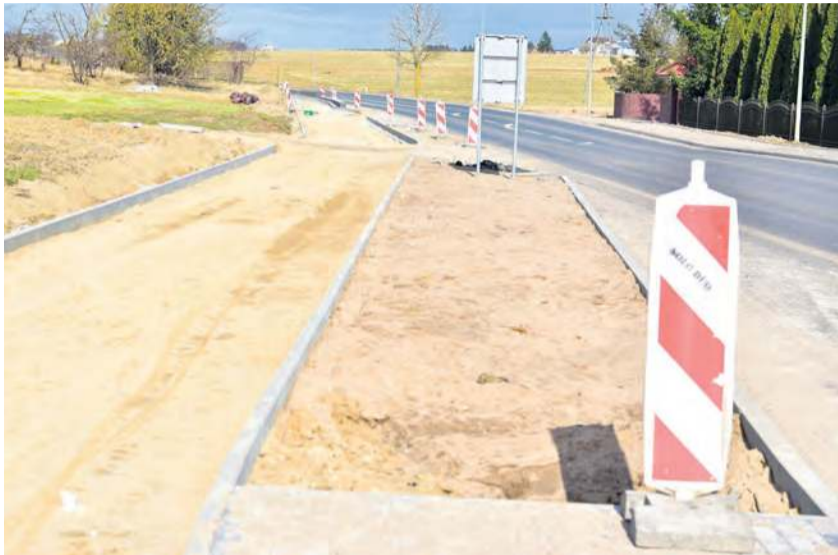
Zakres inwestycji obejmuje: budowę nowych ścieżek rowerowych i chodników, bezpiecznych przejść dla pieszych, kanalizacji deszczowej, oświetlenia oraz zatok autobusowych.
