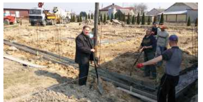
Nie każdy zdaje sobie sprawę, że od budowy świetlicy minęło już sporo czasu
