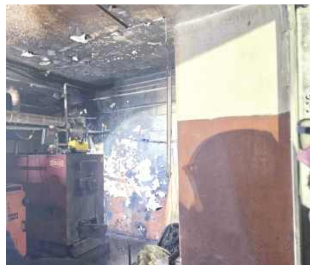
Zniszczona kotłownia w szkole w Starej Róży (fot. OSP Stoczek Łukowski, OSP Stara Róża)
